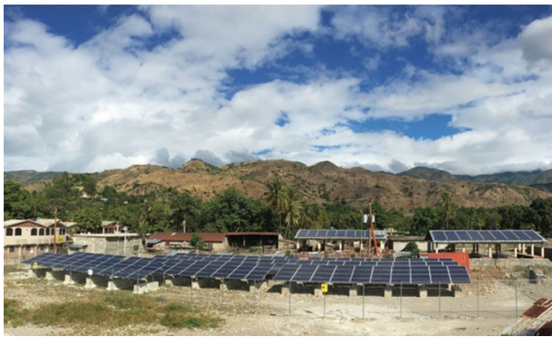
Fig. 7 Les Anglais solar microgrid in Haiti [36] .
